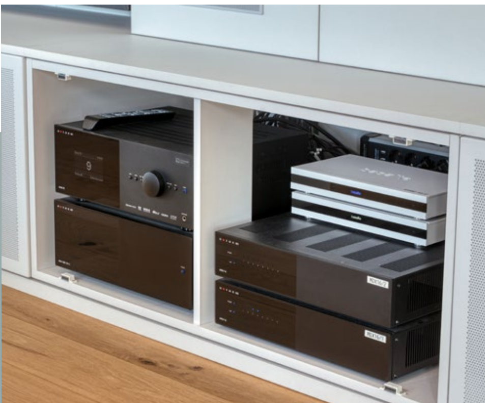
High End in jeder Ecke: Hier verstecken sich Geräte von Anthem (schwarz) und die Core Server von Basalte (silber)
